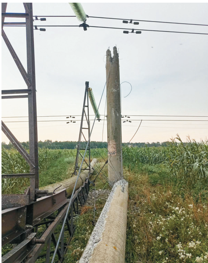
Сломанная опора линии 330 кВ напротив фермы в Мозырском районе
